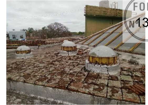
Foto 2 Cubierta en aulas: losas de HºAº con carpetas de cemento, membranas asfálticas y cobertura de ladrillos cerámicos
