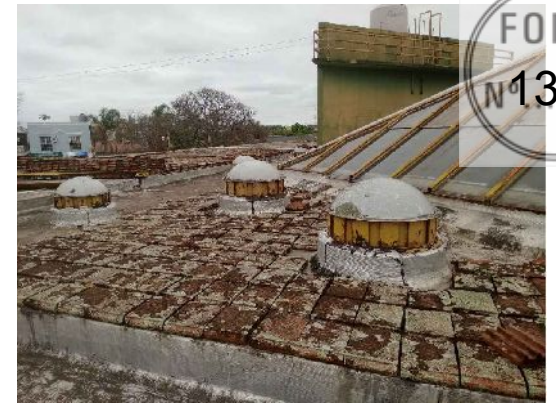
Foto 2 Cubierta en aulas: losas de H º A º con carpetas de cemento, membranas asfálticas y cobertura de ladrillos cerámicos
