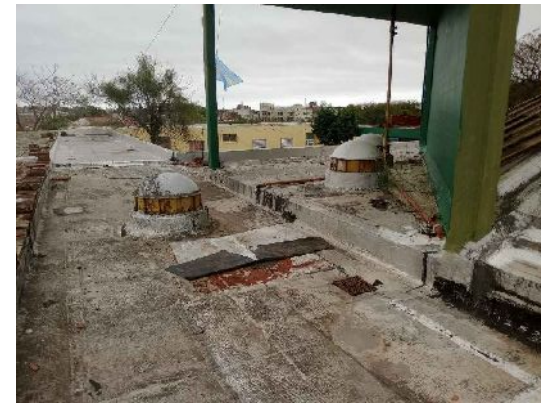
Foto 1 Cubierta de galerías: losas de H º A º con carpetas de cemento y membranas asfálticas
