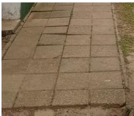
Pisos nuevos o a reparar de baldozones de piedra lavada.
