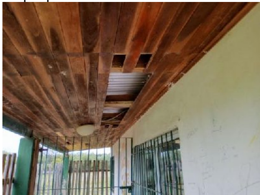
Cielorrasos a reparar en galerías e interiores.
