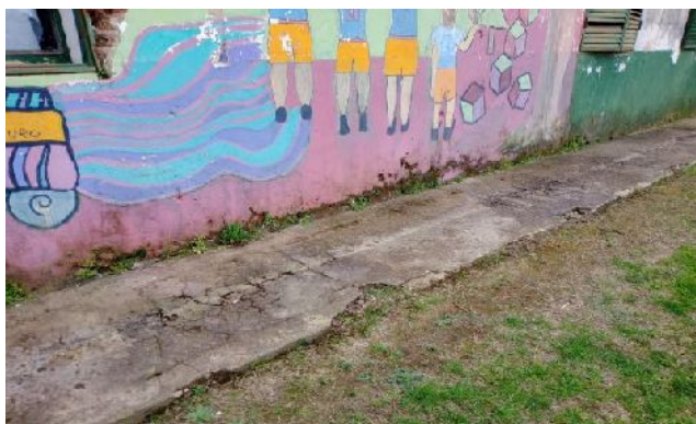
Carpetas inexistentes o deterioradas.
