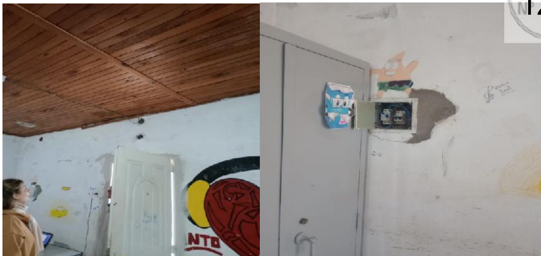
Cableados al aire libre.
